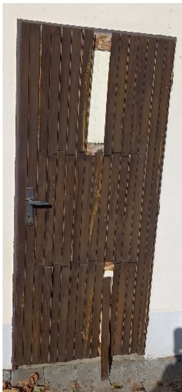
Stav před opravou
